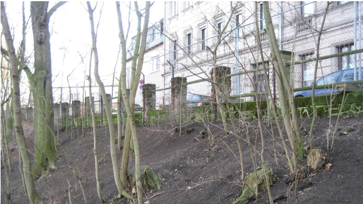
Ansicht Böschung mit Stützwand und Zaun – Blick vom Fußweg Stadtpark zur Engelhardtstraße
