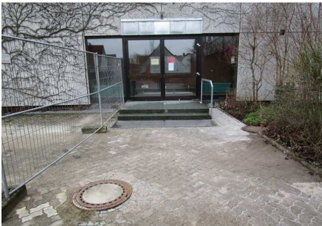
Fehlende Barrierefreiheit Eingang Turnhalle
