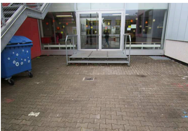
Fehlende Barrierefreiheit Eingang Schulgebäude
