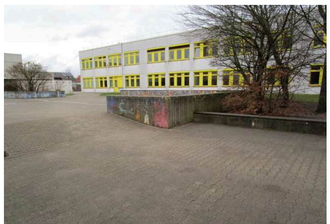
Fehlende Barrierefreiheit Zugang Schulhof Süd
