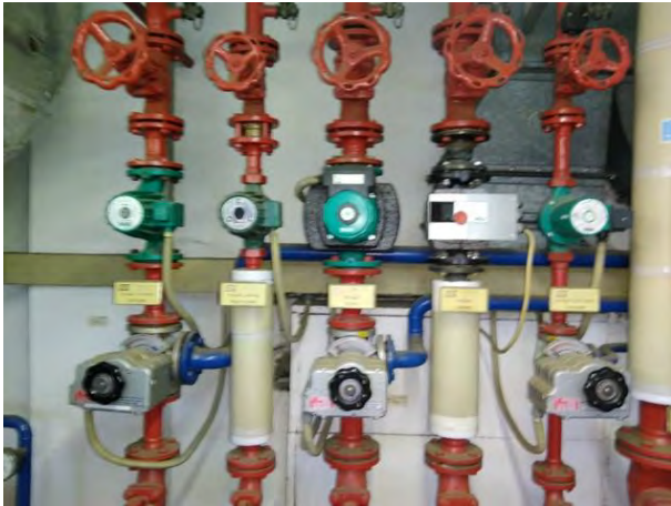
Abbildung 125: Schule Ligusterweg, Heizkreisverteilung
