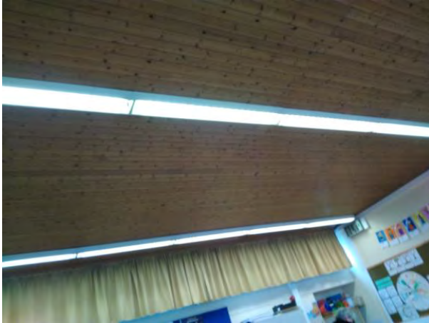
Abbildung 122: Schule Ligusterweg, Beleuchtung Turnhalle
