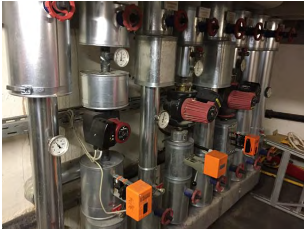
Abbildung 96: Grundschule Friedrich-Ebert-Straße, Heizungsverteilung
