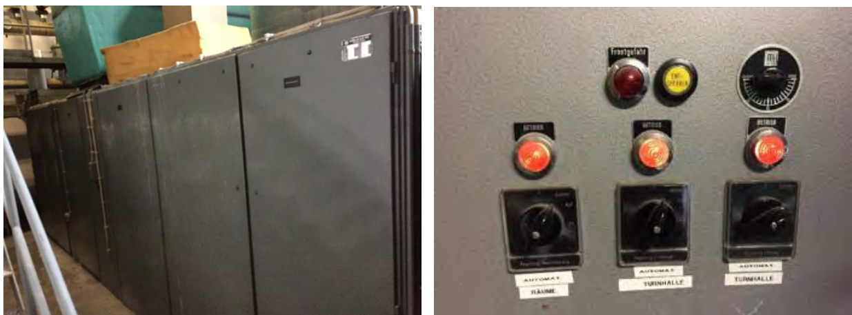
Abbildung 116: Mittelschule Kiderlinstraße, Regelung Lüftungsanlage
