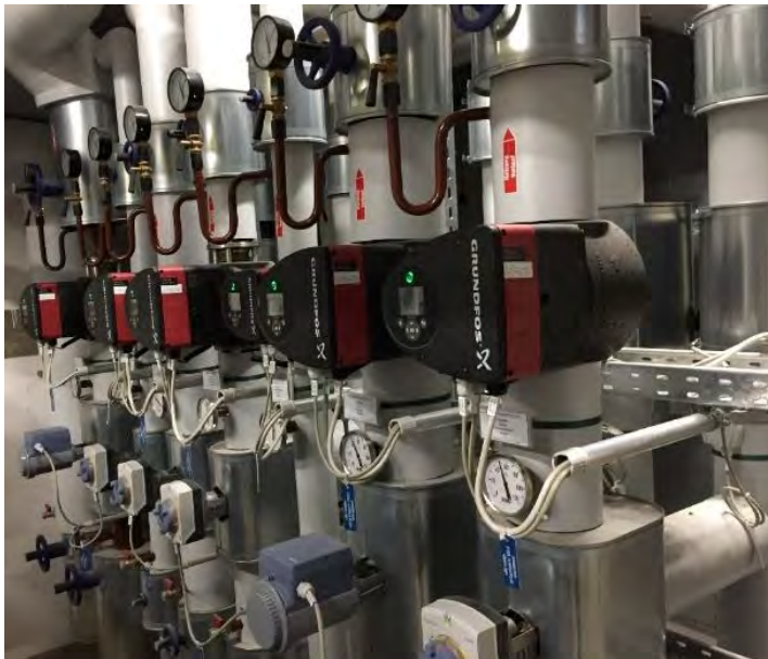
Abbildung 105: Mittelschule Soldnerstraße, Heizkreisverteilung Abbildung 106: Mittelschule Soldnerstraße, Heizungspumpen
