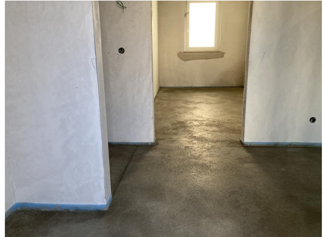
Der Estrich ist zu 70% eingebracht. Das Aufheizen erfolgt in Kürze. Die Elektroinstallation ist im Gange.
