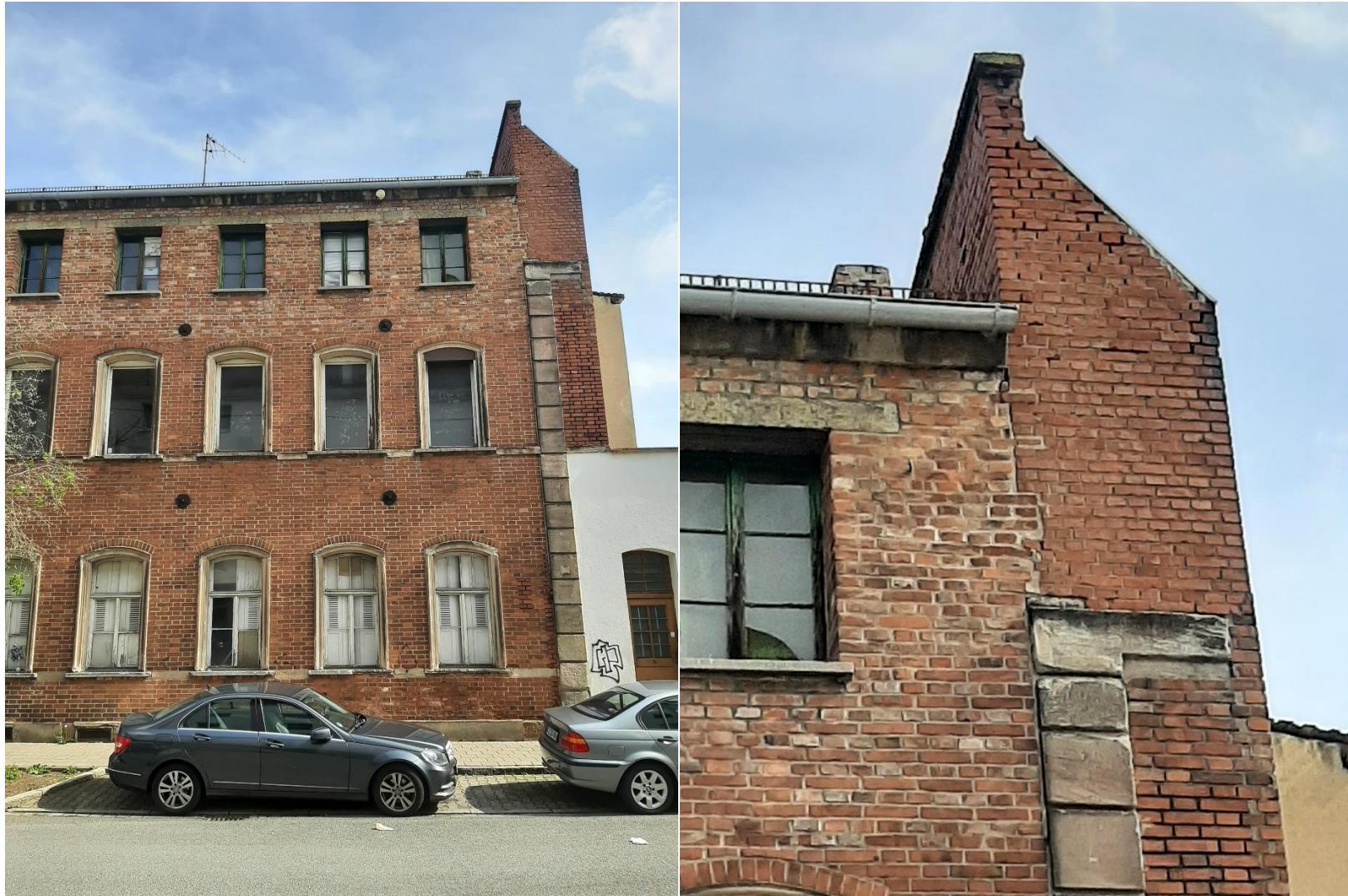
8 und 9: Ziegelsteingebäude mit Spalten und Rissen, geeignet für Fledermäuse und Vögel (z.B. Haussperlingsnester unter Dachrinne, Hohlräume im Mauerwerk)
